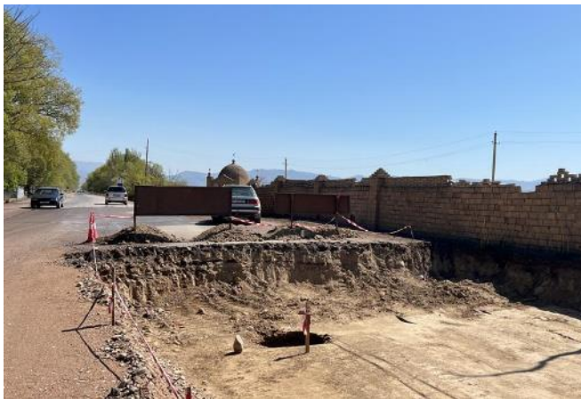
Фото 127. Лот 2. Обнаруженное захоронение, под основанием существующей дороги на км 62+500, с.Тендик.
