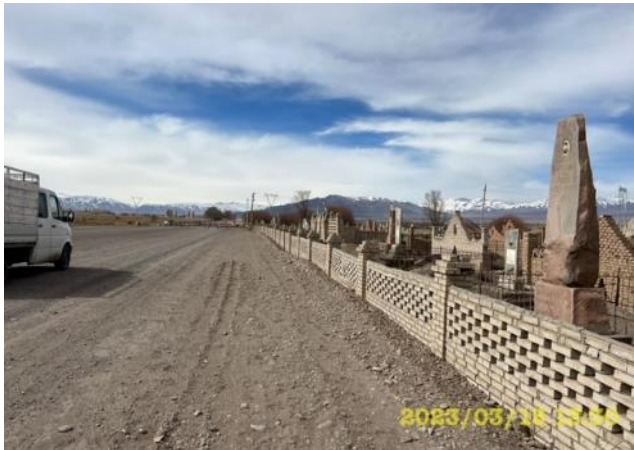
Фото 84. Лот 2. Март. Кладбище на км 68 справа от дороги: фундамент забора кладбища вдоль дороги засыпан грунтом в результате обустройства обочины дороги.
